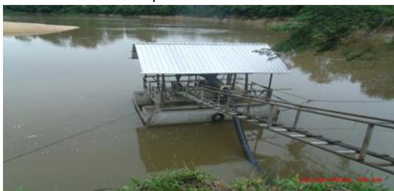
Figura 1: Casa de Bombas da CAERR. Local de captação de água para tratamento e posterior distribuição para a cidade de Rorainópolis. Fonte: Elaborada pelo autor.
