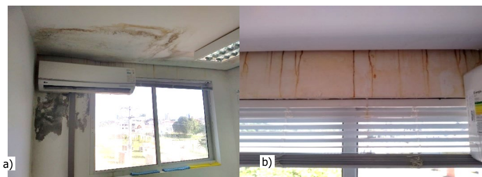
Figura 5 – (a) manchas no forro e descascamento de pintura e (b) manchas na parede.
