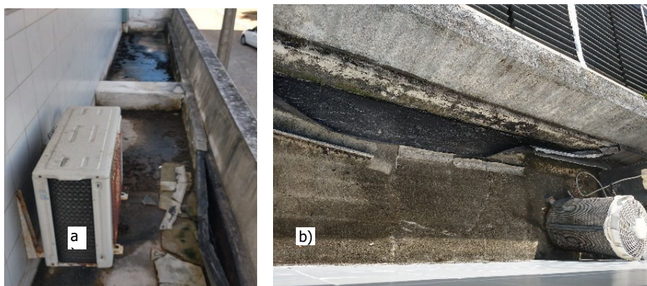
Figura 10 – (a) deslocamento, trincas e declividade de piso inadequada e (b) detalhe do descolamento da manta na laje técnica do 4º pavimento - falha na aderência.
